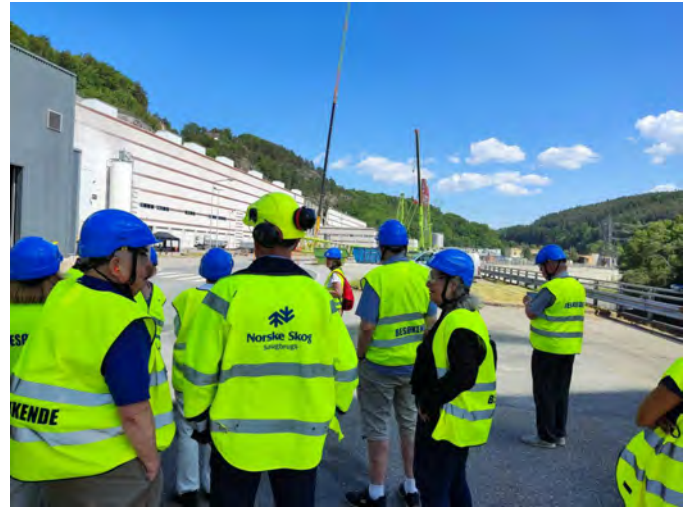
Fabriken i Halden är placerad med "ryggen" nära en hög bergsvägg. En del av denna har rasat och skadat PM6 och dess fabriksbyggnad. Reparation pågick vid besöket med bl.a. den största lyftkranen i Norge.
