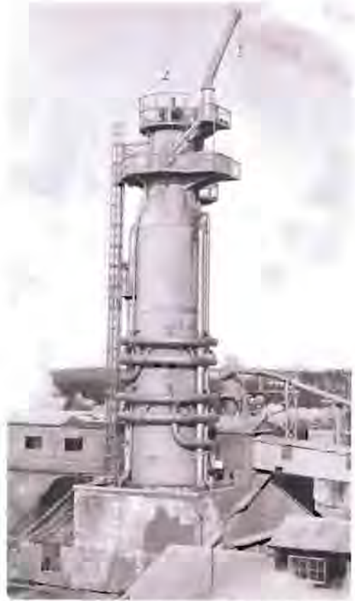
Runt 1960 hade utvecklingen av kontinuerliga sulfatkokare, kommit så långt att det var sådana som installerades vid om- och nybyggnader. Istället för satsvis kokning matades flis och kokväska in uppifrån i ett jämnt flöde.
